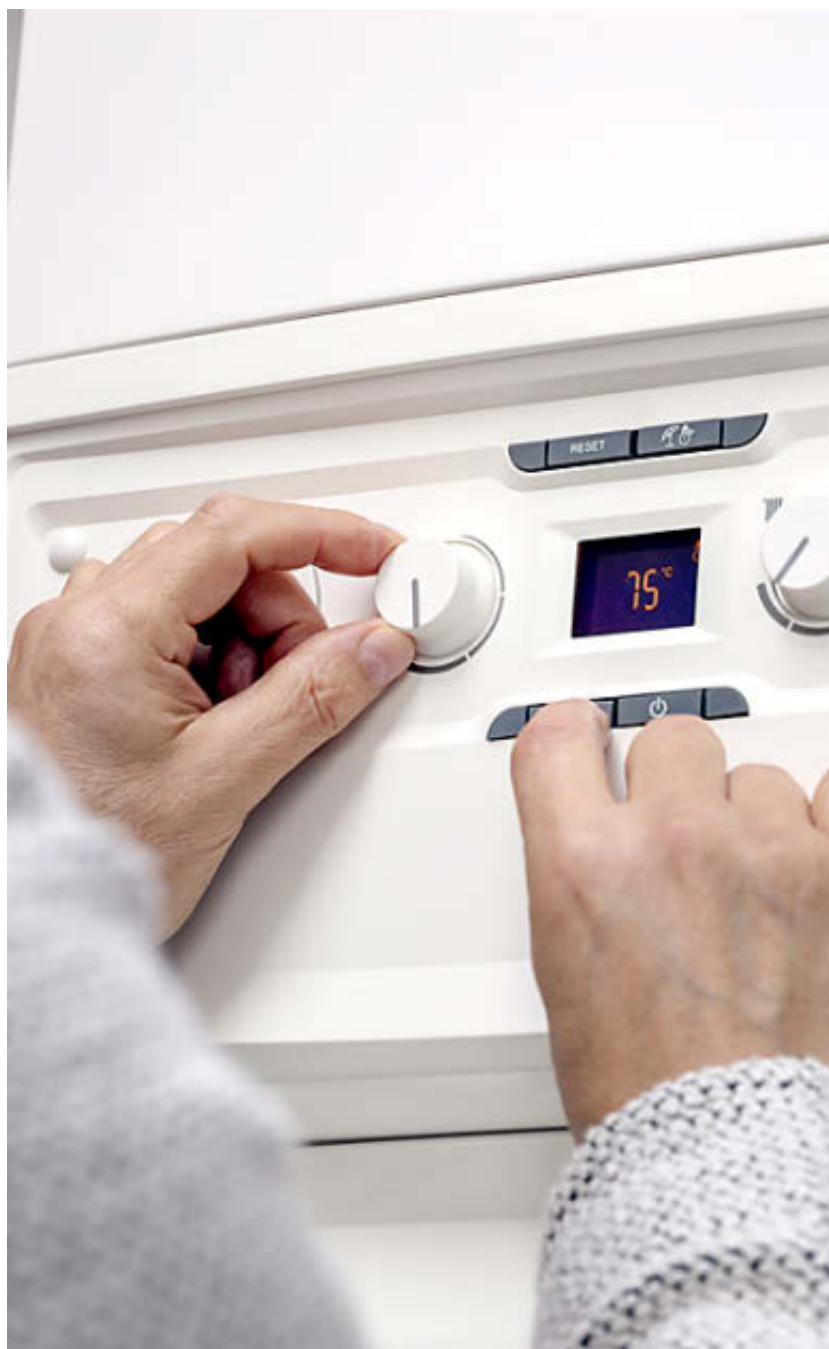
Persona ajusta la configuración del termostato en la caldera de calefacción central.
